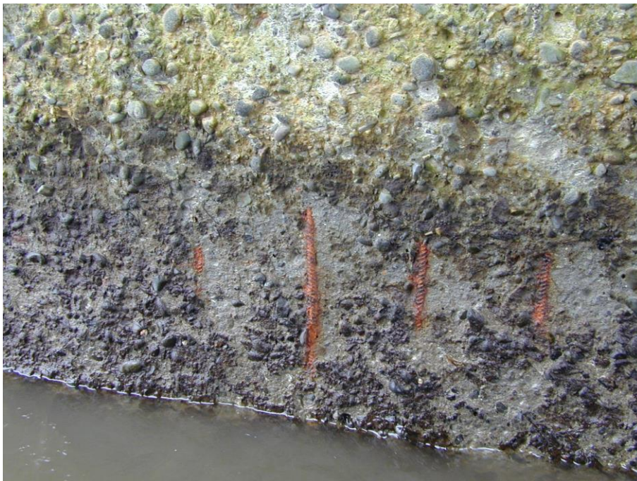
Mynd 1. Óvarið bendijárn í neðri fjörumörkum í Borgarfjarðarbrú. Yfirborðsflögnun er allt að um 50 mm, en steypuhulan var um 50 mm. Myndin er tekin árið 2000.
