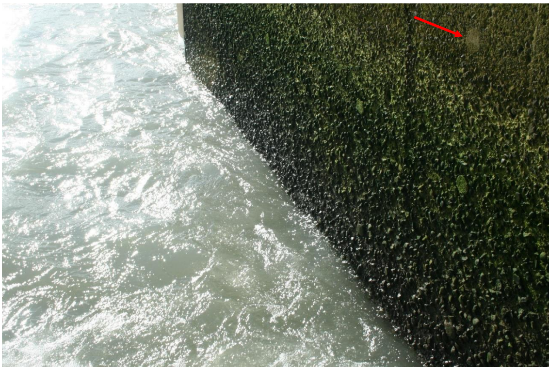
Mynd 7. Óseyrarbrú, stöpull 5. Flögnun í steypunni fyrir neðan meðal fjörumörk. Rauða örin bendir á sama kónagat og örin bendir á, á myndinni hér fyrir ofan. Flögnun úr yfirborði er áætluð allt að um 30 mm. Neðstu fjörumörk eru ekki alveg komin í ljós.
