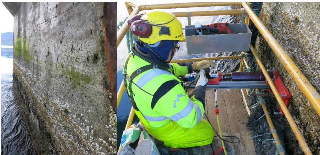
Mynd 14. Dýrafjararbrú. Engar skemmdir voru sjáanlega í yfirborði steypunnar t.v. Kjarni boraður úr neðri fjörumörkum t.h.
